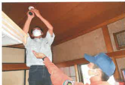
一人暮らし宅の火災報知器の設置
